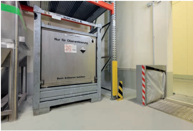
Bild 1 Regalbefestigung in einem Lager für wassergefährdende Substanzen
